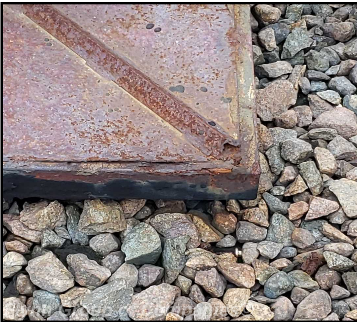
Section A: Area of rusted fan top
