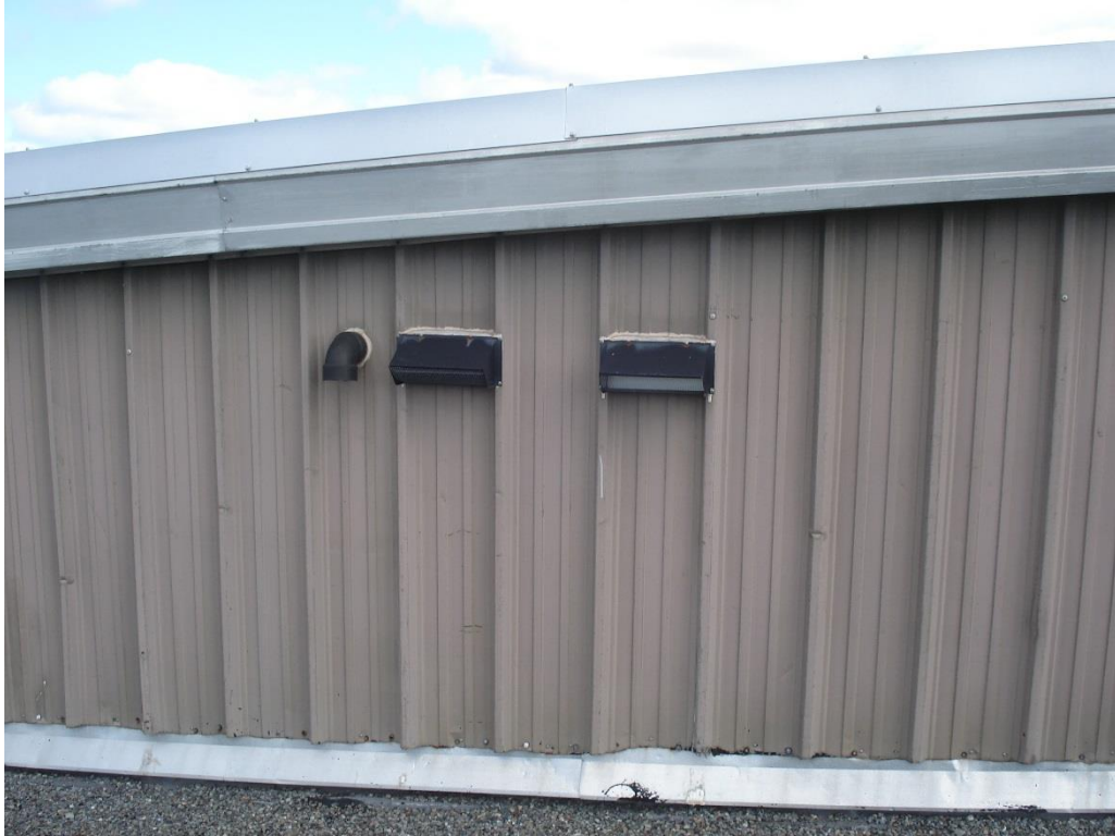
Photo 37 - Exhaust Fan Wall Caps
